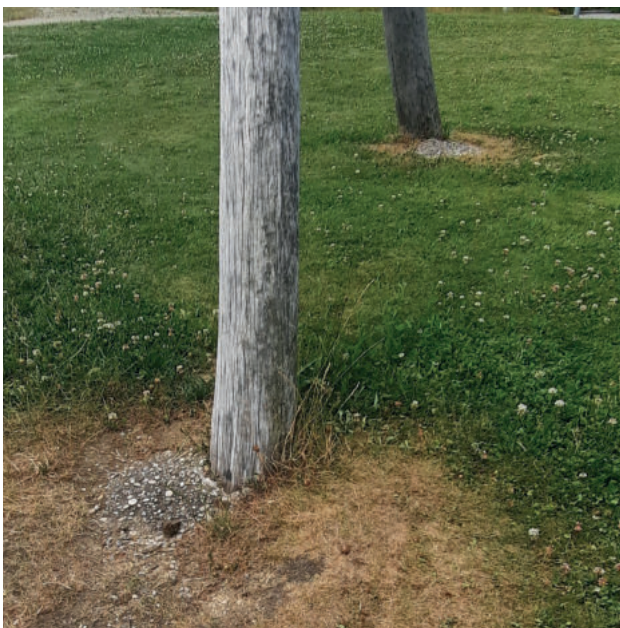
Dieses Fundament wurde nicht tief genug gesetzt.
